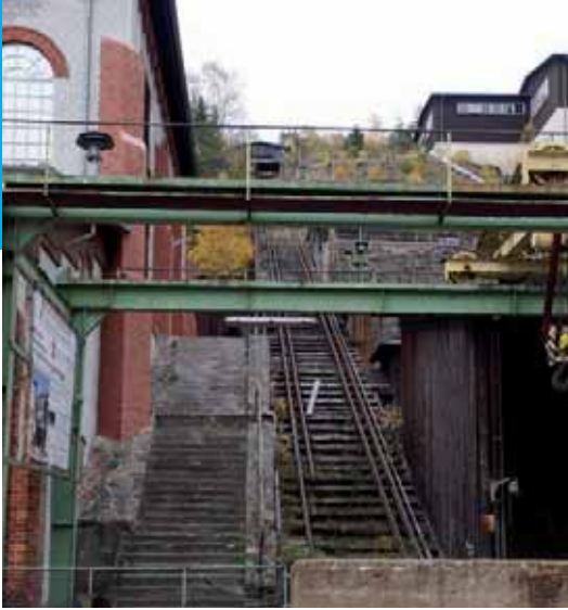
Sobald die 110 Meter lange Gleisstrecke saniert ist, kann die Schrägförderanlage am Rammelsberg wieder in Betrieb genommen werden.
