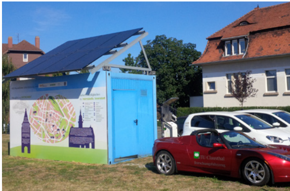
„Energiebox“ zur Speicherung regenerativer Energie in Helmstedt zur Speisung von Elektrofahrzeugen mit Hilfe einer Schnellladesäule.
