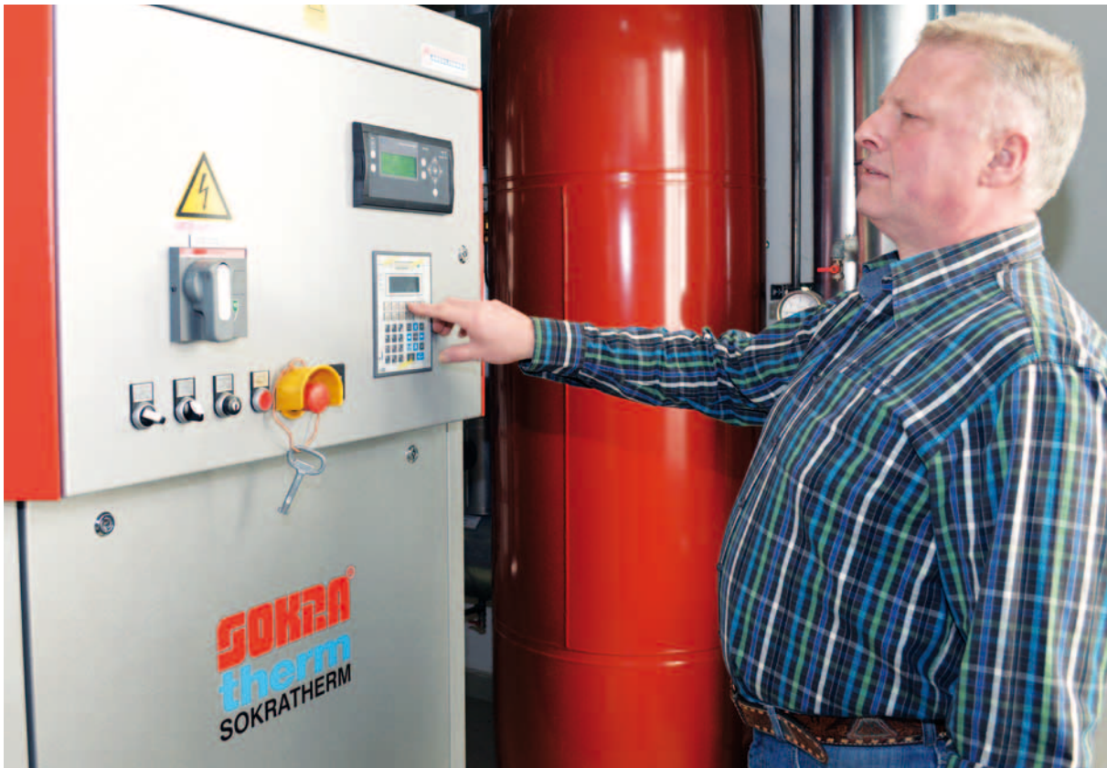
Inbetriebnahme der Taupunktregelung der EFZN-Kraft-Wärme-Kälte-Kopplung (KWKK)
